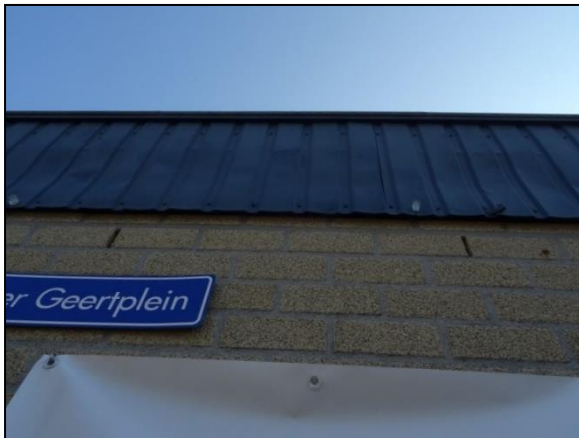
Figuur 14. Buitenvoeging aan het schoolplein met open stootvoegen.
